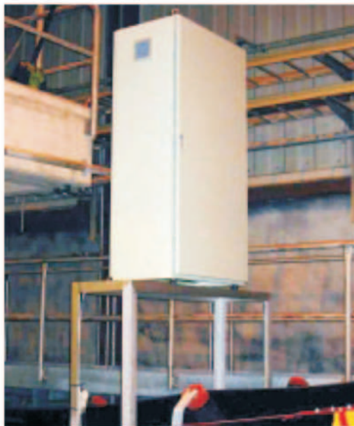
Измерительный модуль (камера и подсветка), установленный на конвейер для коры
